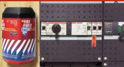
Meterkast of ketelruimte
